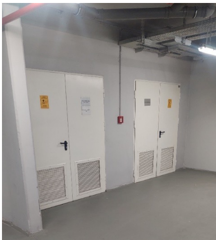
Slika 5. Energetsko postrojenje u garaži
